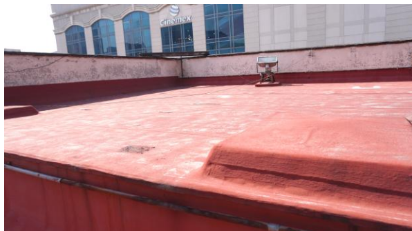
Figura 16. Estado inicial en cubiertas.
