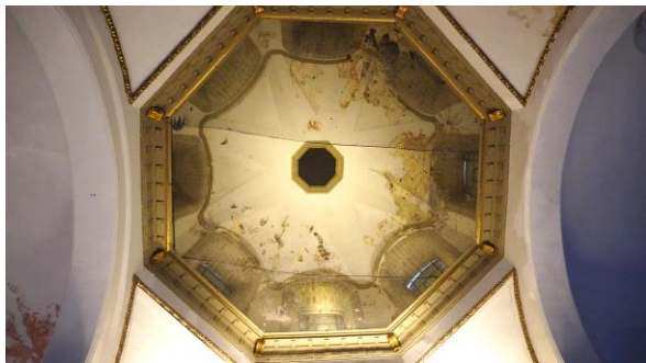
Figura 10. Estado Inicial de intradós de Cúpula Principal.
