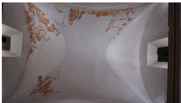
Figura 4. Estado Inicial de intradós de bóvedas de Nave Principal.
